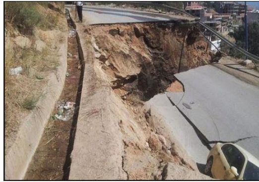
Fig. 15 : Glissement au niveau de la ville de Bejaia
